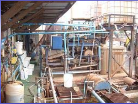
Planta de tratamiento Riles
