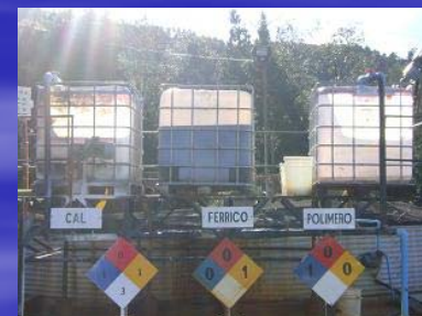
Planta de tratamiento Riles
